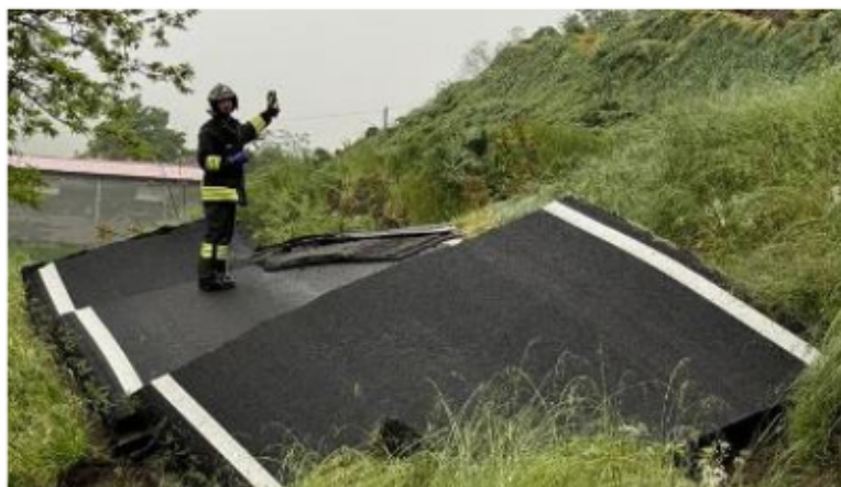
La strada distrutta dalla frana a Porcentico, frazione di Predappio
